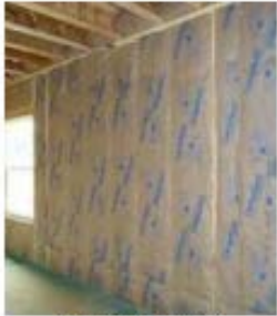
Grade I: Compliant
