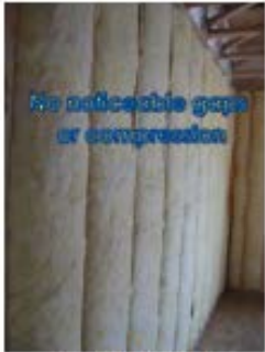
Grade I: Compliant
